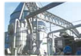
銘建工業バイオマスボイラー
